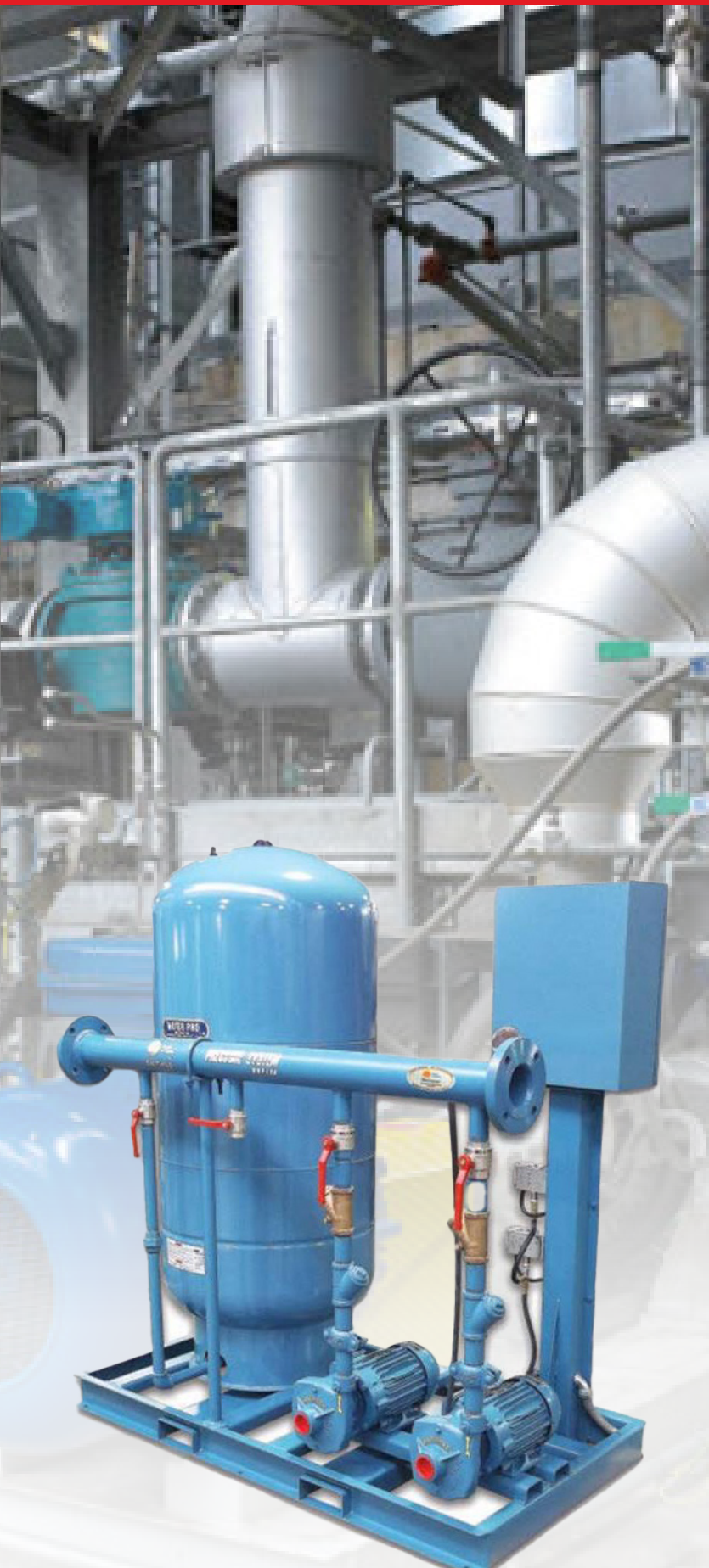
SISTEMAS DE BOMBEO
